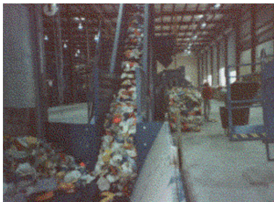
Εικόνα 71. Χοάνη υποδοχής των υλικών και ταινιόδρομος
